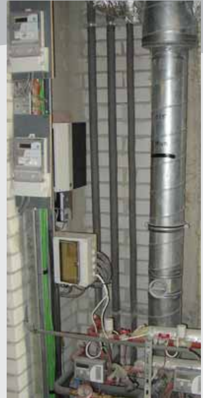
All målere er placeret på centrale lodrette rør
